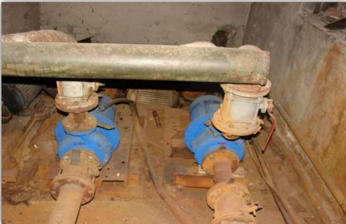
Рисунок 2.2.1.2.3. Вспомогательное оборудование котельной(насосы).
