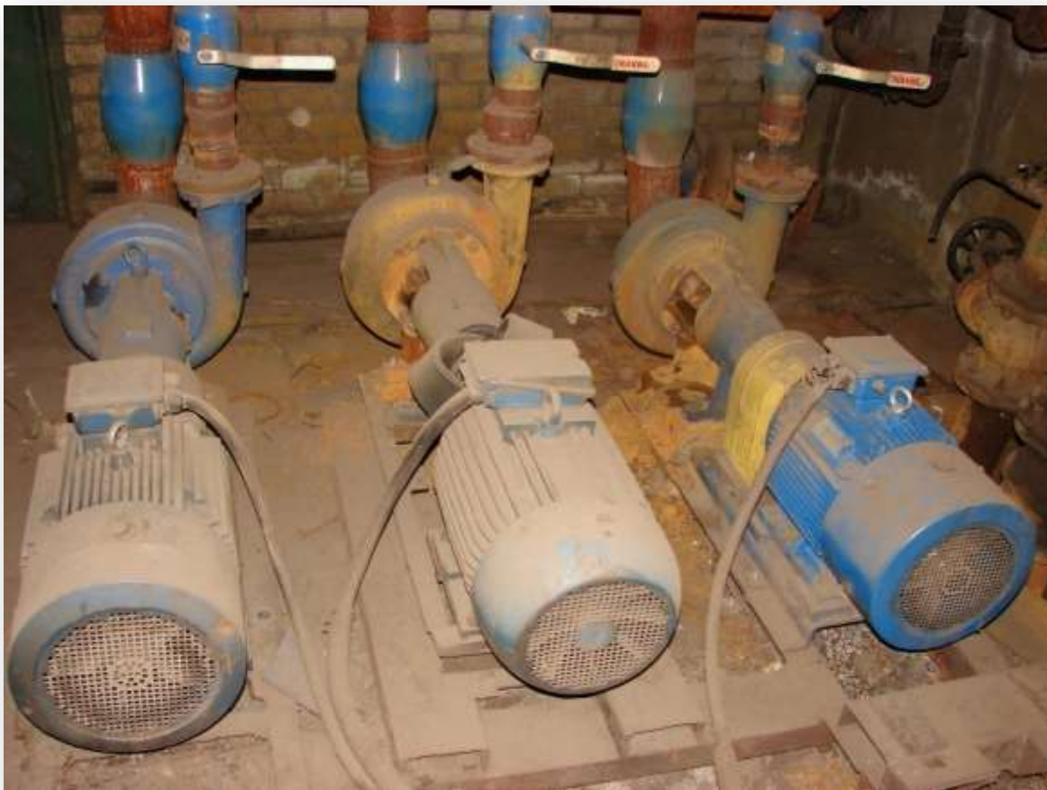
Рисунок 2.2.1.1.5 Вспомогательное оборудование котельной (насосы).
