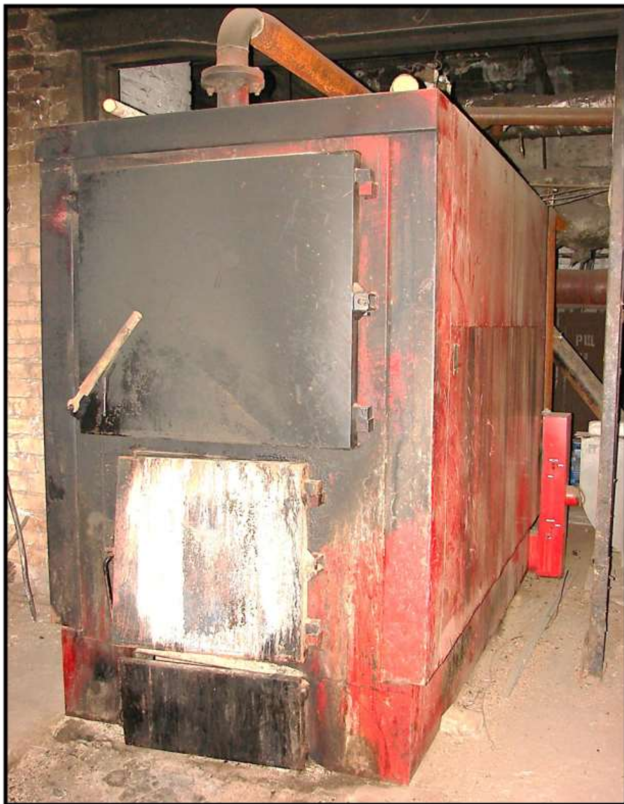
Рисунок 2.2.1.1.4 Водогрейный котел АК 1000.
